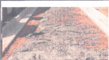
FOTO - 02: CONCRETO NA CICLOVIA
